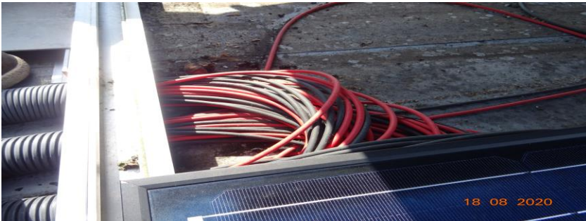
Kabels op het dak
