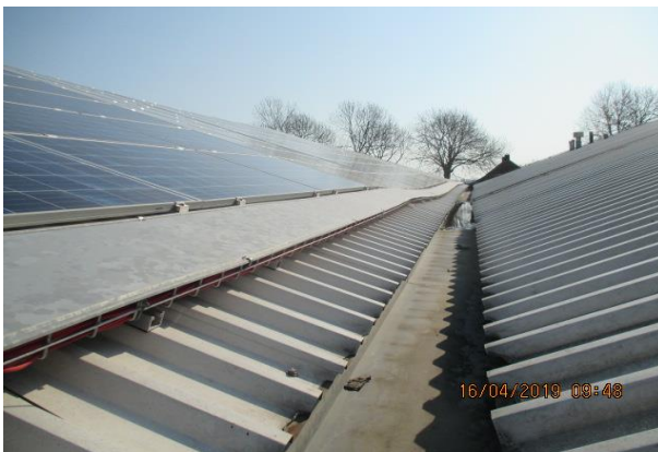
Doorzakken van het dak Bron : Univé
